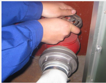
5、打开消防栓阀门
