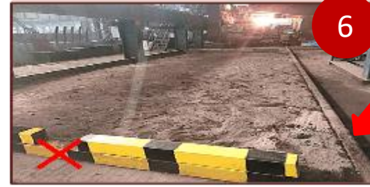
中间罐事故坑容量不足
