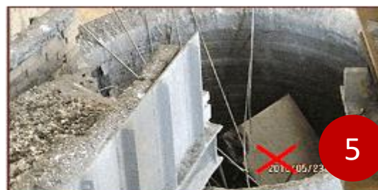
事故罐/坑杂物堆积维护不足
